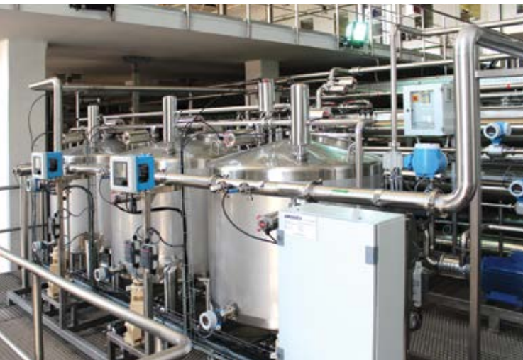
Установка электродеионизации, 5 x 100 м 3 /ч
