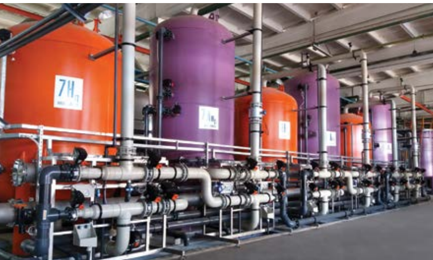
Установка деминерализации Arionex, 950 м³/ч
