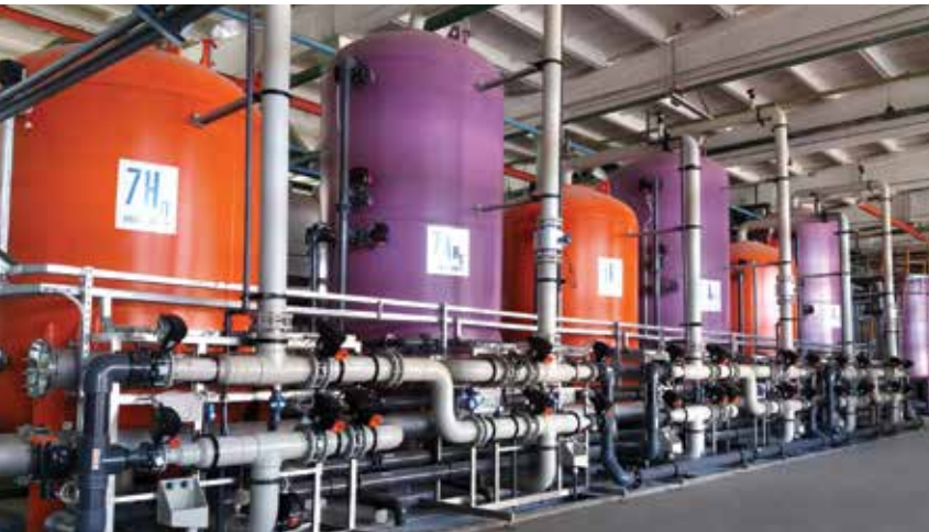
An Arionex demineralisation plant, 950 m 3 /h
